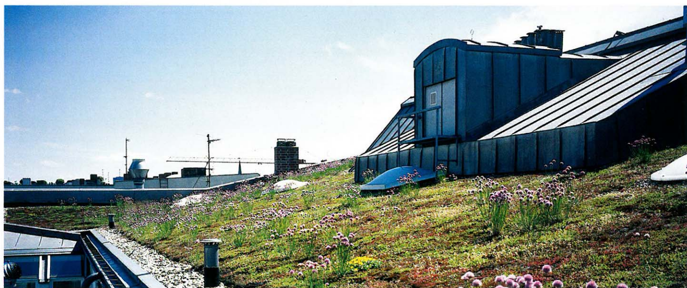
Extensive Dachbegrünung auf dem flach geneigten Berliner Dach des Vorderhauses, rechts die Heizzentrale hinter den Kollektoren. Foto: solidar, Dr.-Ing. Günther Ludewig
